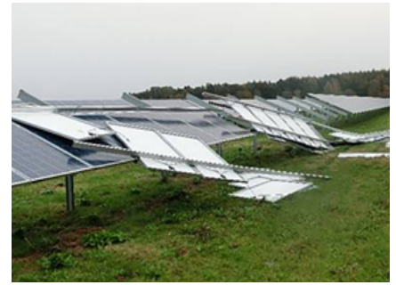
Abb 2 — Sturmschaden in einem Freiflächen Solarpark. Foto: Cedrik Zapfe •
