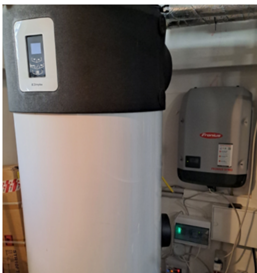
Abb 2 — Die Brauchwasser-Wärmepumpe mit dem Wechselrichter •
