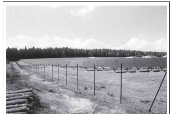
PV-Freiflächenanlage auf dem ehemaligen militärischen Gelände in Hemau Foto: Georg Engelhard
