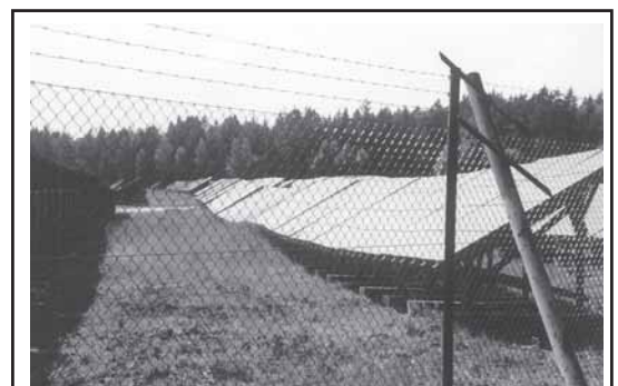
PV-Freiflächenanlage auf dem ehemaligen militärischen Gelände in Hemau Foto: Georg Engelhard
