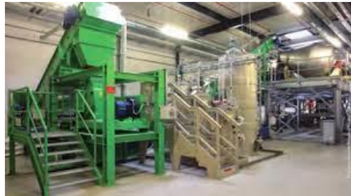
Foto: Recyclinganlage von First Solar (links: Hammermühle, mittig: Fällungseinheit, rechts: Stahltrommel) Quelle: Andreas Wade, First Solar
