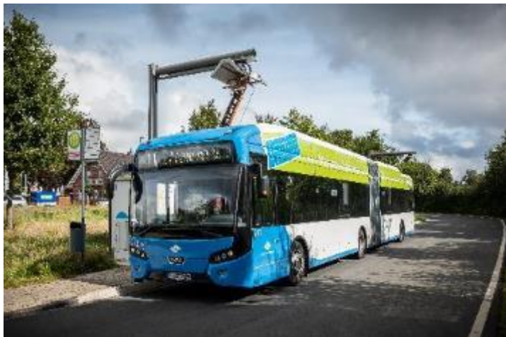
Schnellladestation für zwei Gelenkbusse
