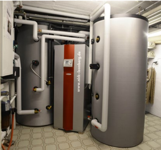
Abb 7 — Warmwasserspeicher im Heizungskeller zur Speicherung der Wärme. Foto: Bundesverband Wärmepumpe (BWP) e.V. •
