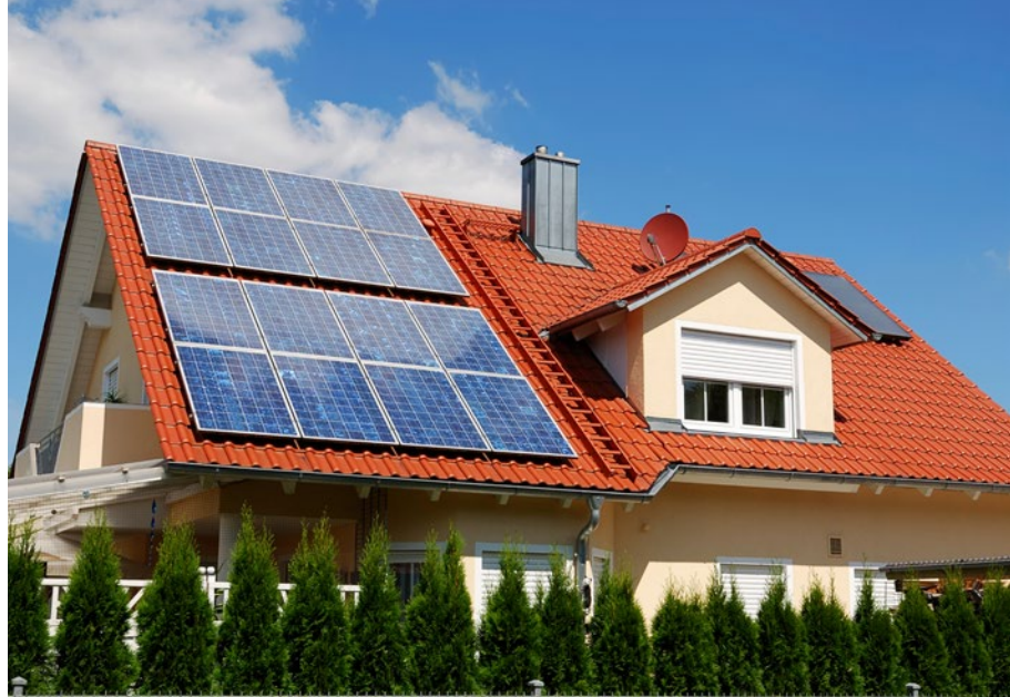
Abb 2 — Photovoltaik-Anlage mit horizontalem Wartungsgang. Bei nötigen Kontrollen oder Reparaturen können Solarteure:innen so alle Paneele gut erreichen. Bei den meisten Anlagen werden Wartungsgänge nicht berücksichtigt. •
