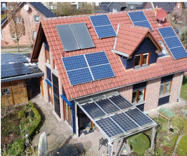
Abb 1 — Im Haus von Anne Bussmann kommen fast alle Arten von Solarmodulen zum Einsatz. Hier im Fokus: die Glasdach-Anlage über der Terrasse •
