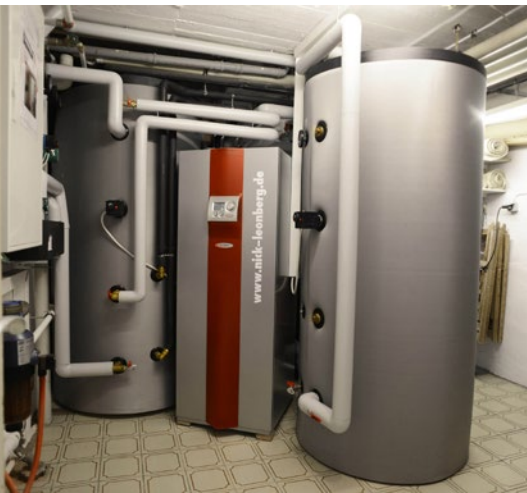
Abb 7 — Wärmwasserspeicher im Heizungskeller zur Speicherung der Wärme. Foto: Bundesverband Wärmepumpe (BWP) e.V. •
