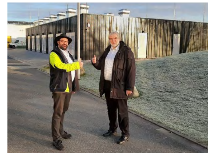
Abb 3 — Diese Großbatterie steht in Bordesholm und hat eine Gesamtkapazität von 15 MWh. •
