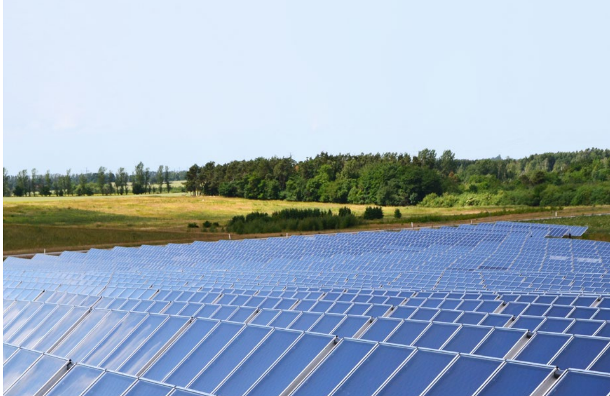
Abb 4 – Wärmeproduktion seit Frühjahr 2018: 11.312 m 2 große Freiflächen-Solarthermieanlage in SmørumFoto: Aalborg CSP •
