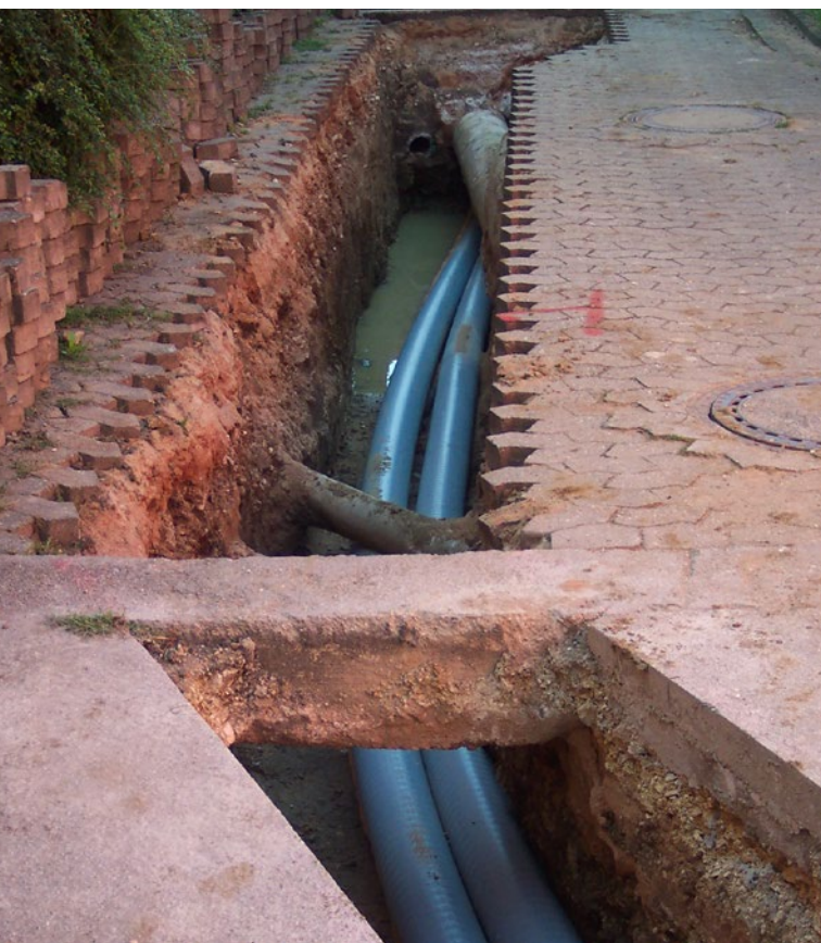
Abb 1 — Die isolierten Leitungen der Nahwärme müssen sich durch viele bestehende Netze zwängen (Telefon, Strom, ...)
