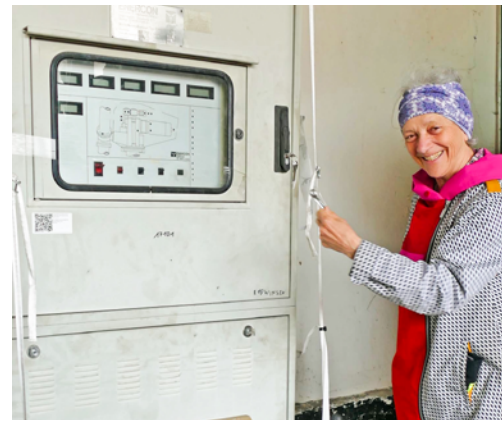
Abb 2 — Der Schaltschrank der 80kW Windanlage muss ausgetauscht werden. •
